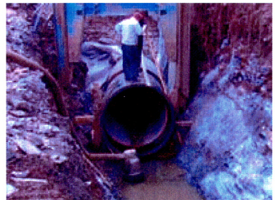
Durch Rohre unter der Flusssohle strömt das Wasser in die Turbinen.
